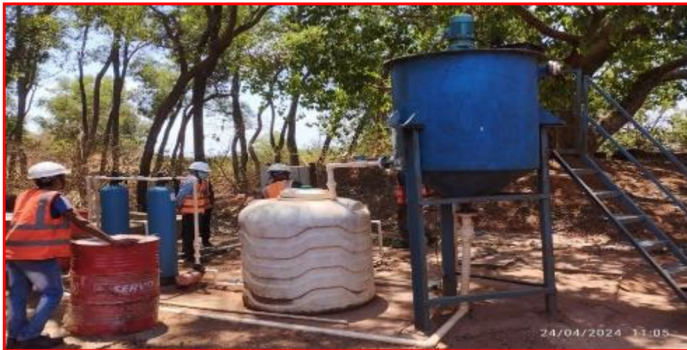
Effluent treatment plant (ETP)
