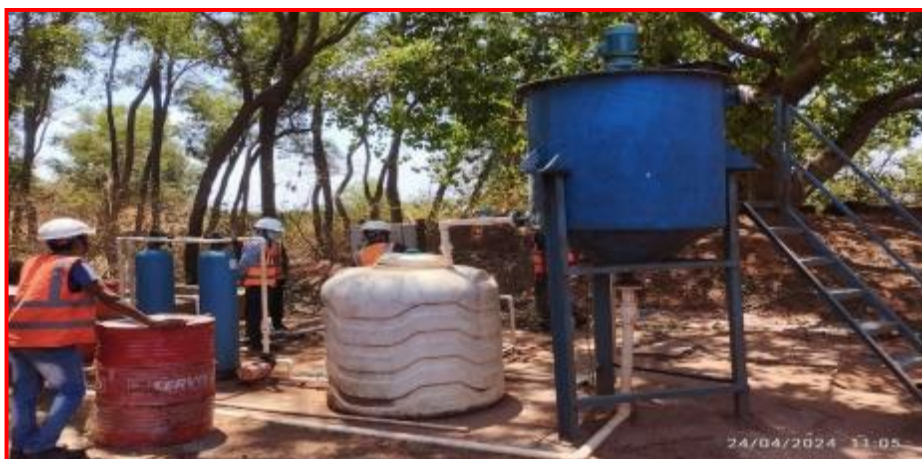
Effluent treatment plant (ETP)
