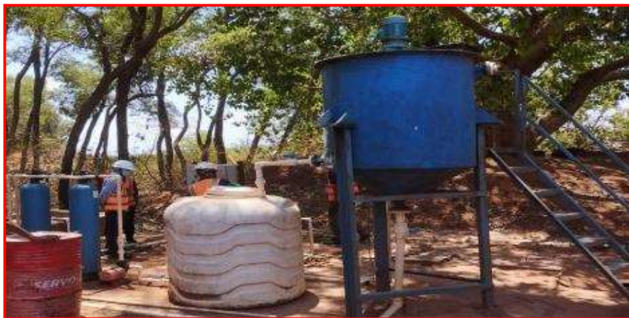
Effluent treatment plant (ETP)
