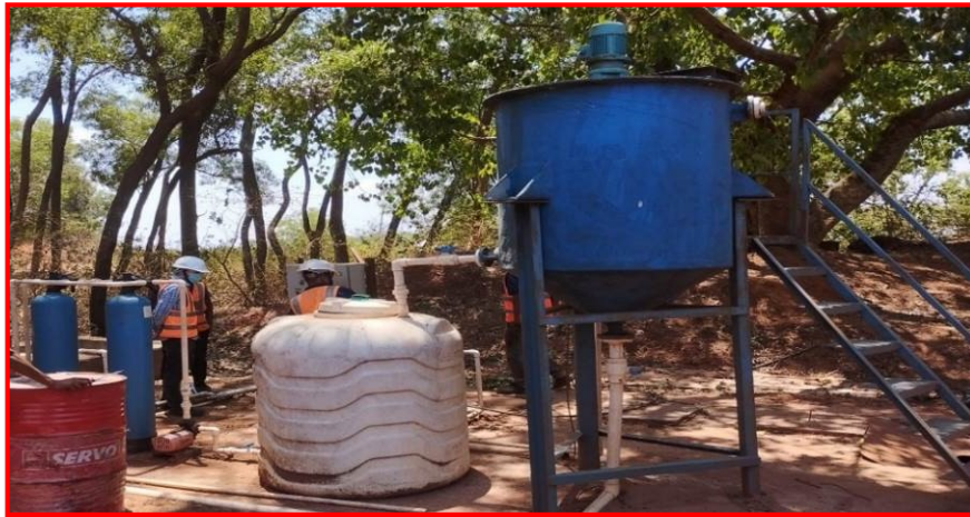
Effluent treatment plant (ETP)
