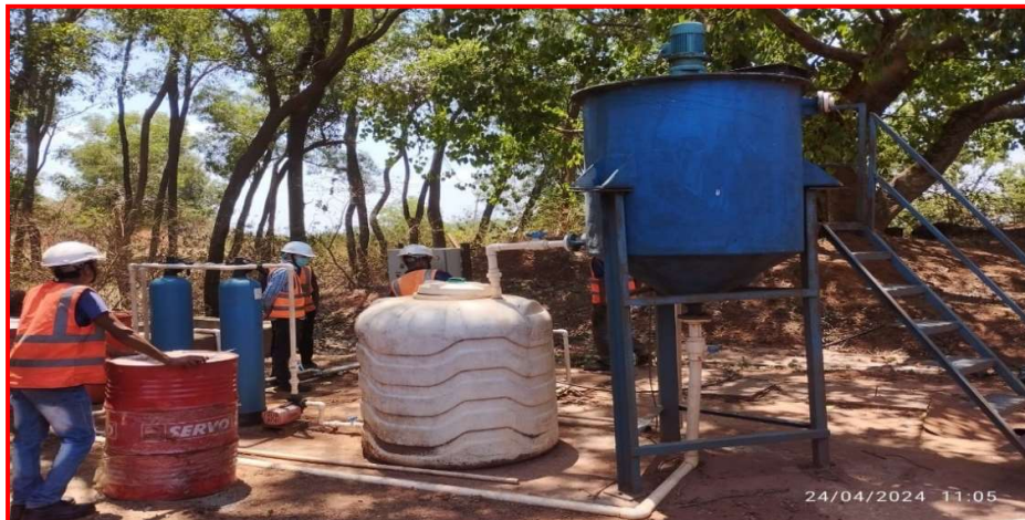
Effluent treatment plant (ETP)
